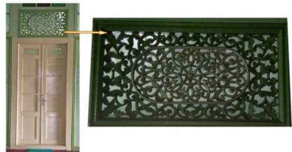
Gambar 18. Ventilasi pintu rumah kaca (Sumber: Patriansah & Hariansyah, 2018)
