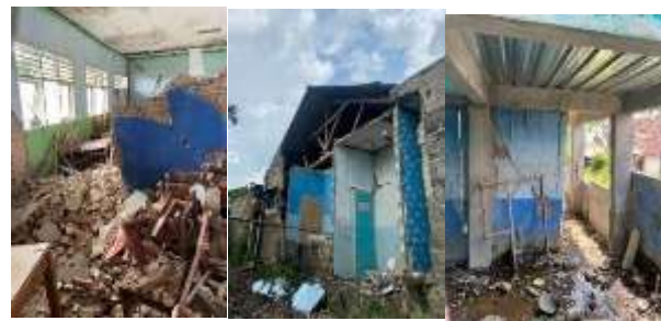
Gambar 9. Contoh Kerusakan Bangunan.
