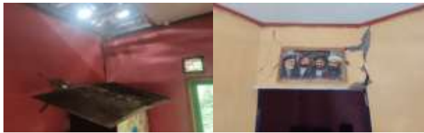
Gambar 1. Foto Kerusakan pada Bangunan Rumah Penduduk
