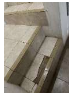
Gambar 5. Kerusakan Bangunan Gereja
