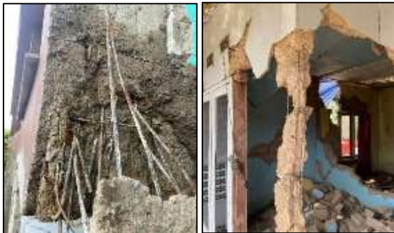
Gambar 22. Kerusakan Struktur Kolom
