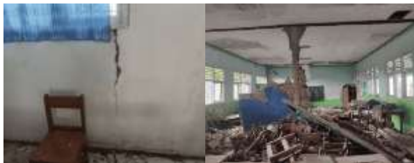
Gambar 2. Kerusakan pada Bangunan Sekolah
