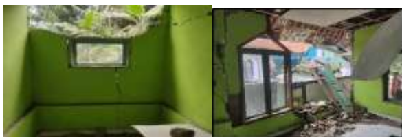
Gambar 3. Kerusakan pada Bangunan Masjid
